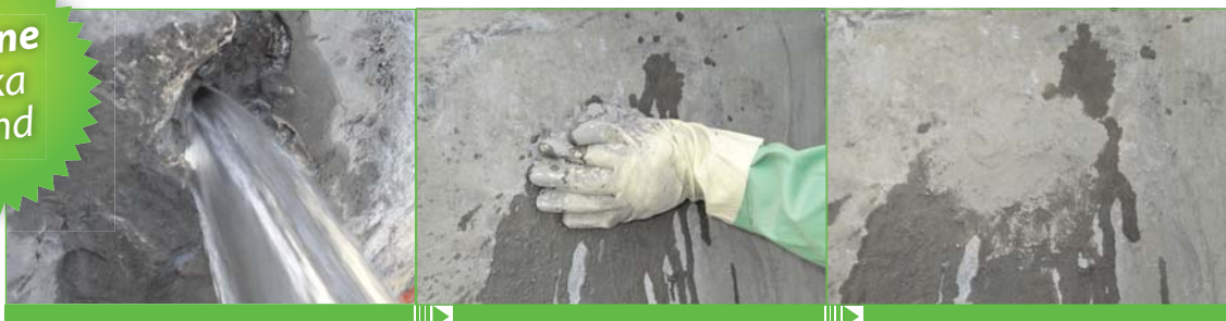
Aktywny wyciek wody jest uszczelniony trwale po aplikacji proszku KÖSTER KD 2 Blitzpulver.
